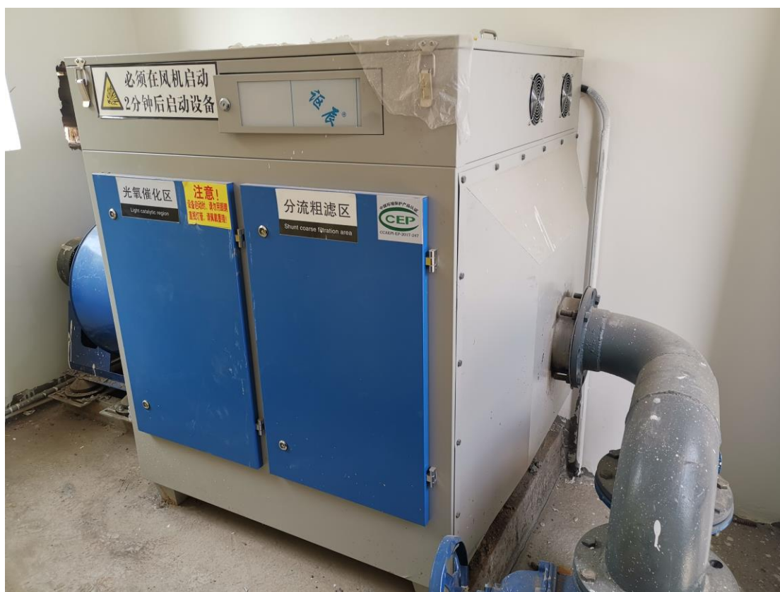
废气处理装置
