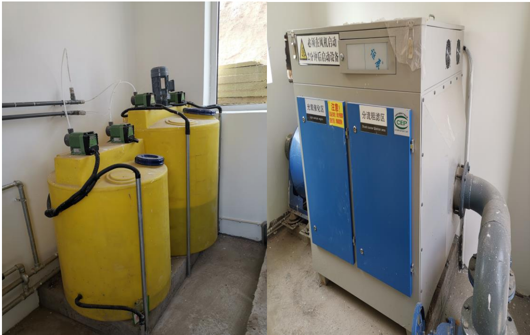
污水处理站污水处理设施
